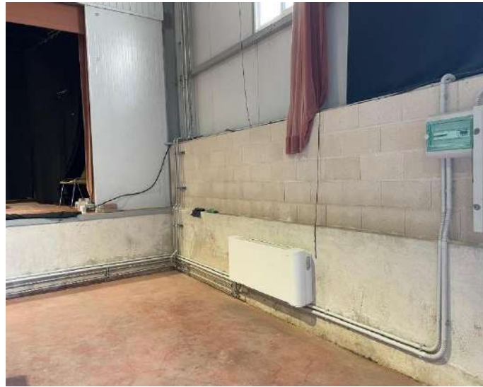
Fotos de la instalación de aerotermia
