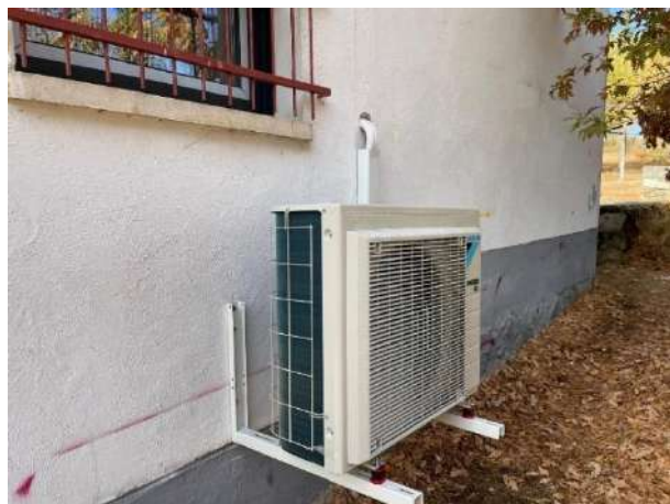
Instalación de aerotermia
